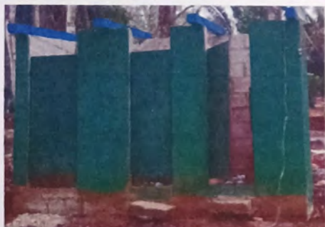
Foto 3: Se observa que el módulo de baños se le ha quitado el techo.
